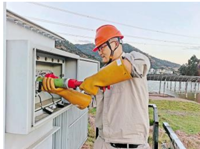
及时维护,避免电量损失
