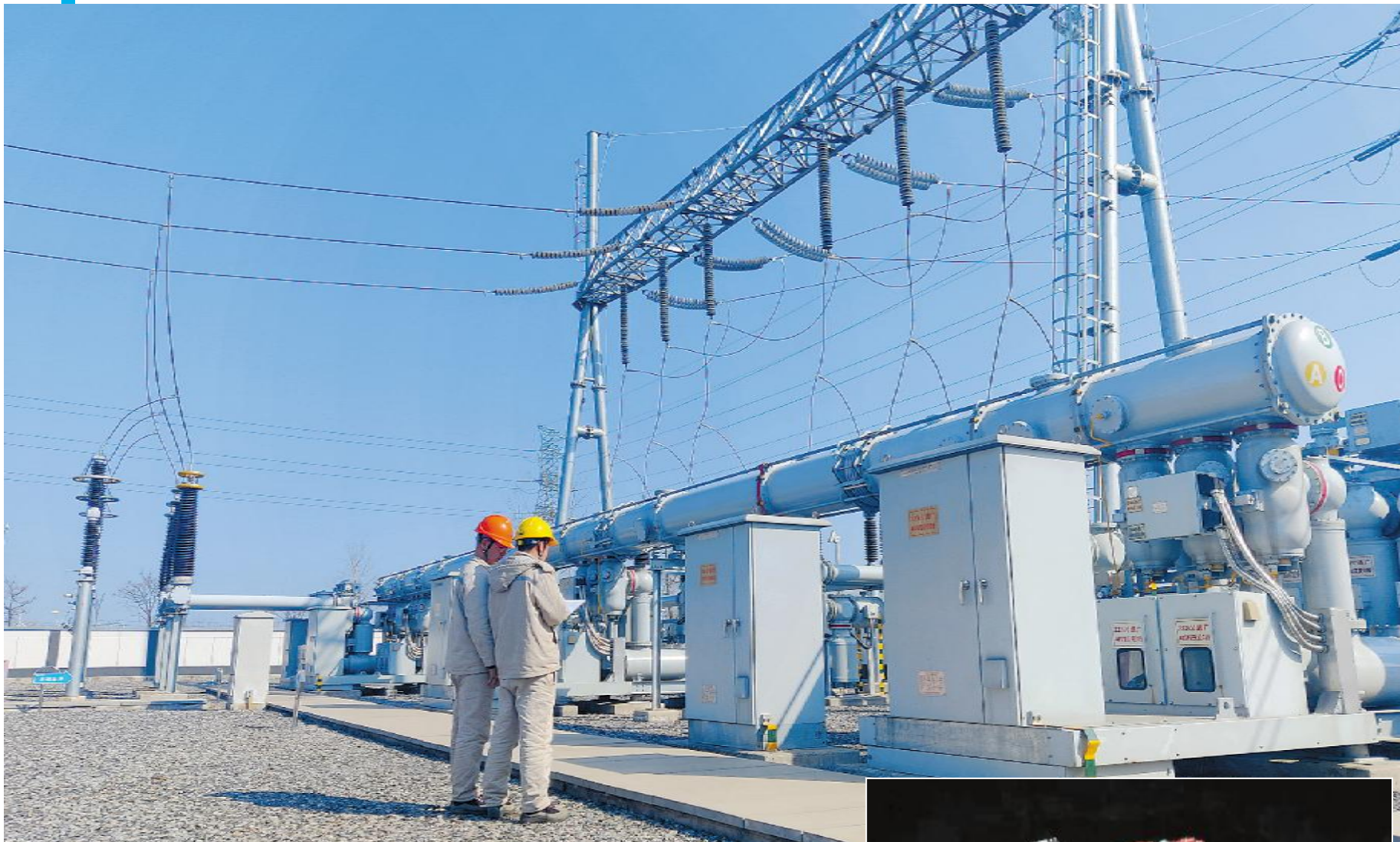
巡检设备,保障安全运行
